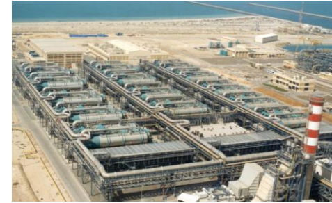
MED Desalination Plants- Al Jubail - KSA
